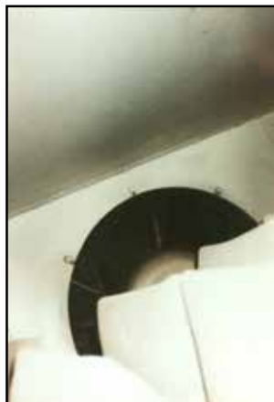
Clean Exhaust Fan
